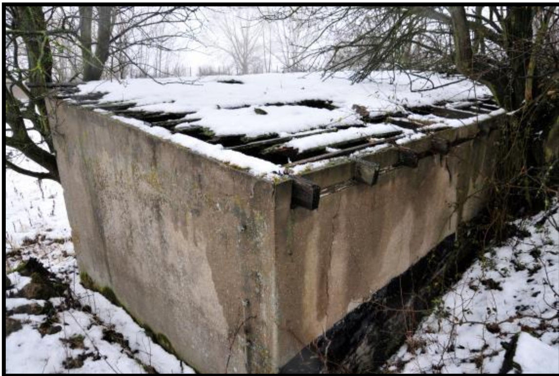
Abb. 7: Kaputte Dachhaut des Schuppens
